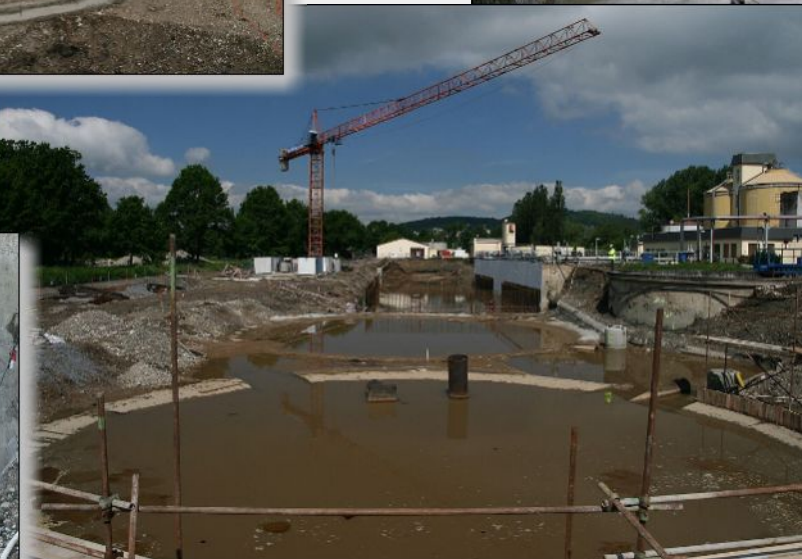
4. červen 2010 – Stavební jáma nové aktivační linky plná vody po zátopě
