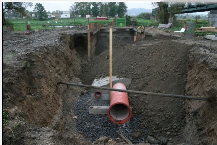
7. říjen 2010 – Budování vzestupné větve shybky pod řekou Otavou na pravém břehu, zásyp štětované stavební jámy shybky
