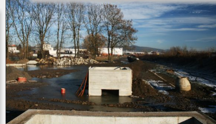
17. leden 2011 – Staveniště levobřežní části sběrače pod vodou po rychlém tání sněhu
