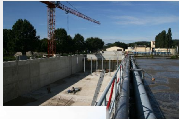
19. srpen 2010 – Nová nádrž de/nitrifikace vedle staré de/nitrifikace
