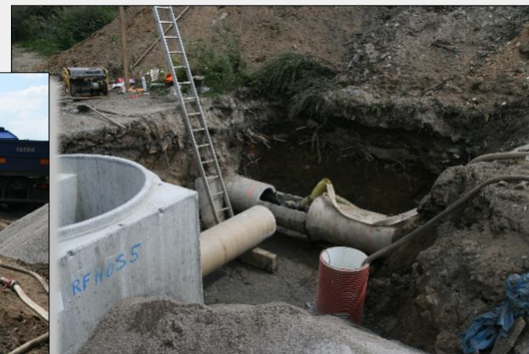
12. srpen 2010 – Výstavba propojení starého a nového sběrače za šybkami pod řekou Otavou
