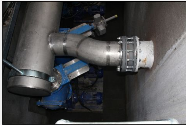
26.červenec 2011 – Potrubí v čerpací stanici na aktivační linky
