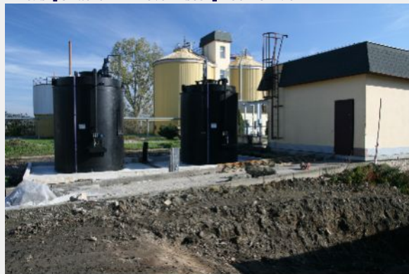
22. říjen 2010 – Nové nádrže chemického hospodářství
