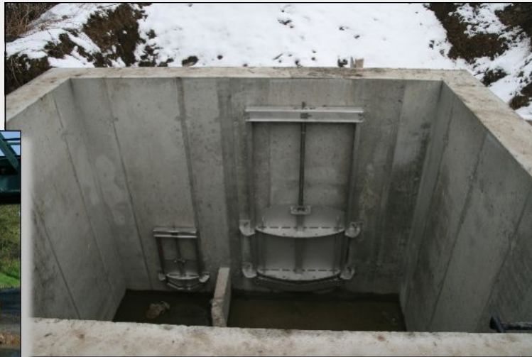
28. leden 2011 – Pravobřežní koncová šachta shybky pod řekou Otavou, osazená nerezová hradítka na konci potrubí
