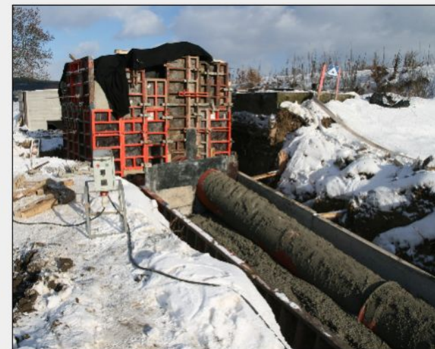
10. prosinec 2010 – Vybetonovaná vstupní armaturní šachta na shybce, obetonování sestupné levobřežní větve shybky pod řekou Otavou
