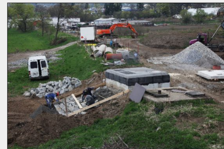
14. duben 2011 – Opevňování protipovodňové hráze v místech výkopu pro uložení potrubí a manipulační šachty shybky pod řekou Otavou
