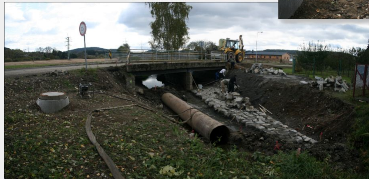
21. říjen 2010 – Obnova kamenného obložení levého břehu koryta Svarýšovského potoka v místě křížení s novým sběračem
